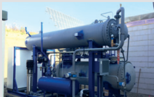
ORC-Anlage für zusätzliche Stromerzeugung aus Wärme
