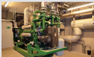
Neues BHKW mit 550 kWelektr zur Strom- und Wärmeerzeugung
